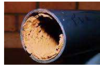
الشكل 27- الترسبات في أنبوب المياه
