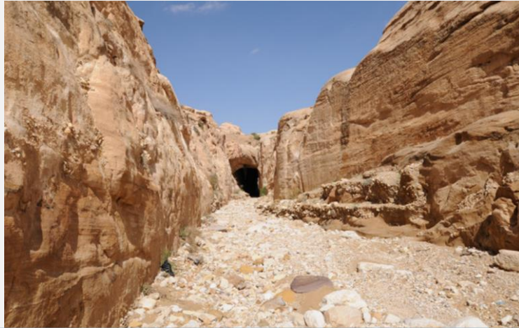
نفق لتحويل مياه الفيضانات يمتد من وادي موسى إلى وادي مدليم في الأردن (Jordan Heritage, 2020)
