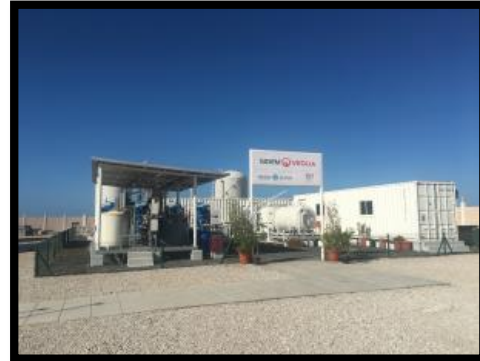
SIDEM VEOLIA Veolia desalination pilot plant
