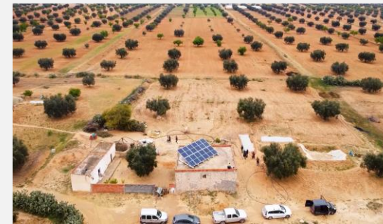
نظام طاقة شمسية سعة 4.5 كيلو واط في مزرعة في شربان، المهديّة، تونس
